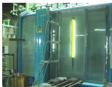
粉体塗装設備
