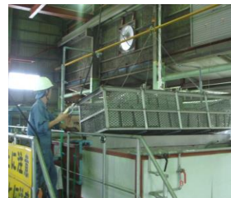
ノンクロム処理設備
