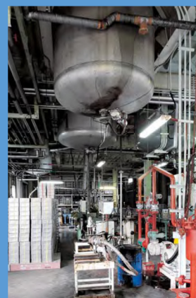
塗料製造設備
