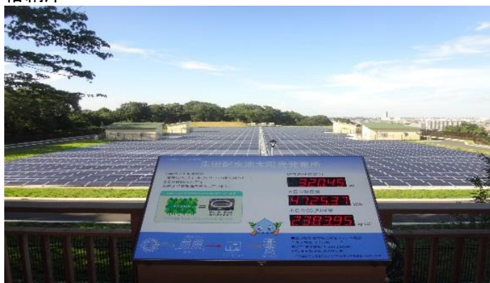
太陽光発電設備
