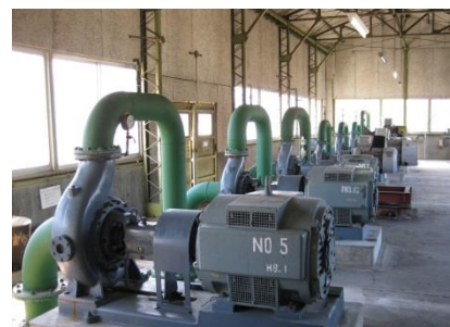
配水ポンプ室
