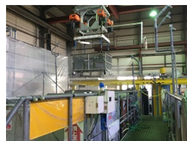
ノンクロム処理設備
