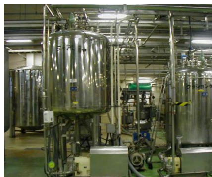
【主要設備:真空脱気装置】
