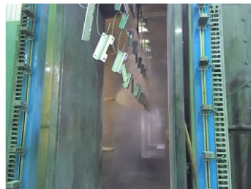
粉体塗装設備
