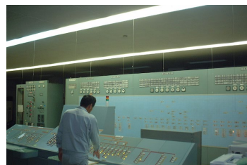
変電設備運転監視
